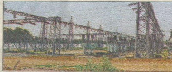
शहर स्थित एक पावर सब स्टेशन।
